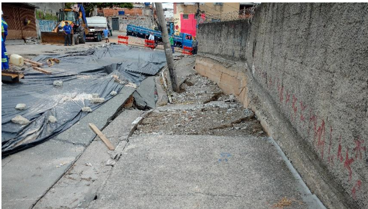
Movimento da contenção interna implicando no afundamento da calçada e rua
