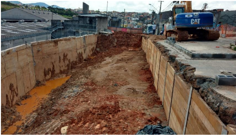
Início da escavação e finalização da contenção provisória em prancha e perfil metálico
